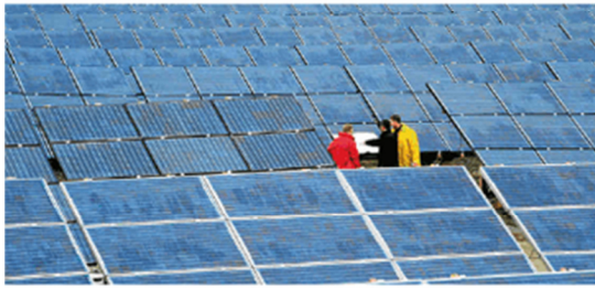
1 Industriell genutzte Fotovoltaikanlage
