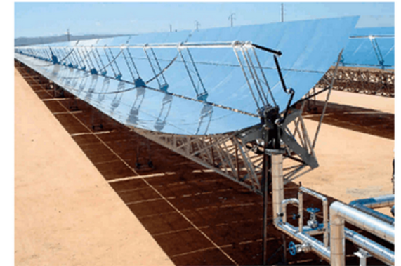
4 Parabolrinnenkollektoren in einem solarthermischen Kraftwerk
